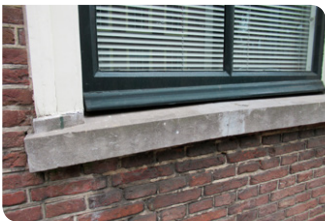
Gebogen hardstenen raamdorpel met rechts een gerepareerde breuk.
